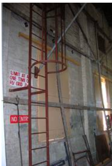
Item 3 (Behind ladder)
